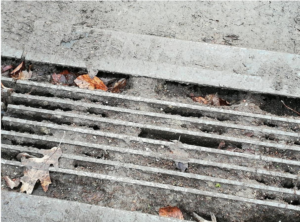
Abbildung 8: Einfahrt zur Schützengilde, statt ein Amphibienzaun dient ein Gitter um das Einwandern der Amphibien ins Gebiet zu verhindern, durch Ansammlung von Erde ist ein Überwinden der Barriere für Amphibien aber problemlos möglich
